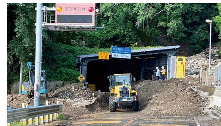
土砂で埋もれた国道8号トンネル 令和4年8月5日 敦賀市余座 福井県ホームページ
