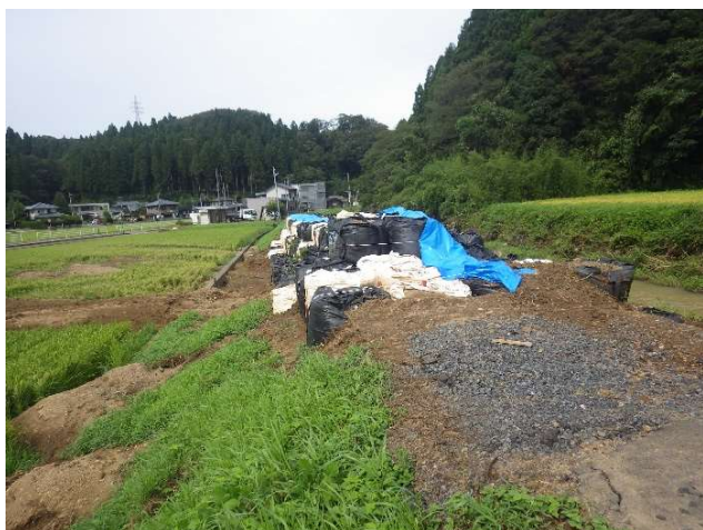
写真-6 決壊箇所上流部
