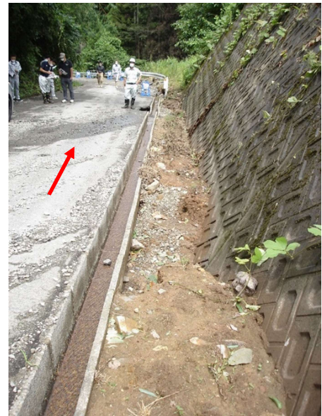
写真-2 谷側側溝の溢れ
