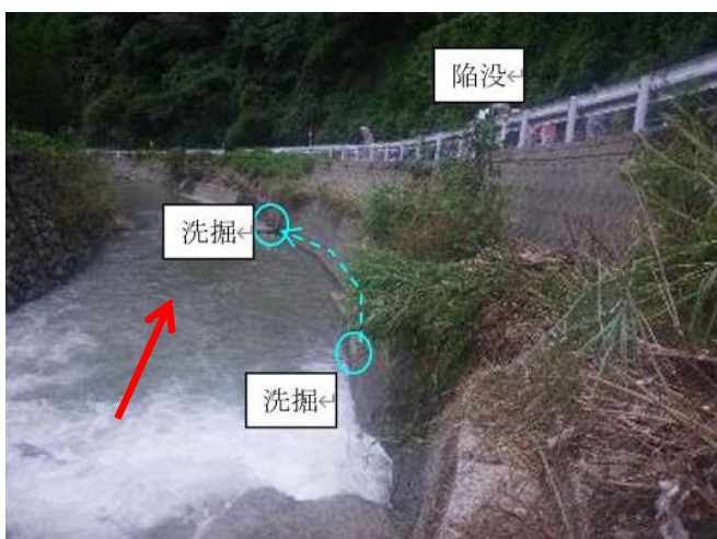
写真-7 陥没箇所（上流側から）
