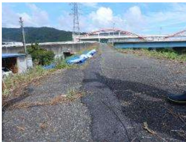
写真-4 舗装の古い亀裂と補修跡
