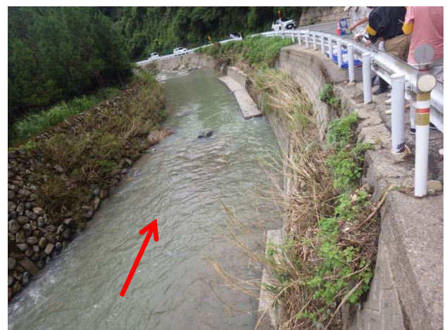
写真-8 陥没箇所（上流側から）
