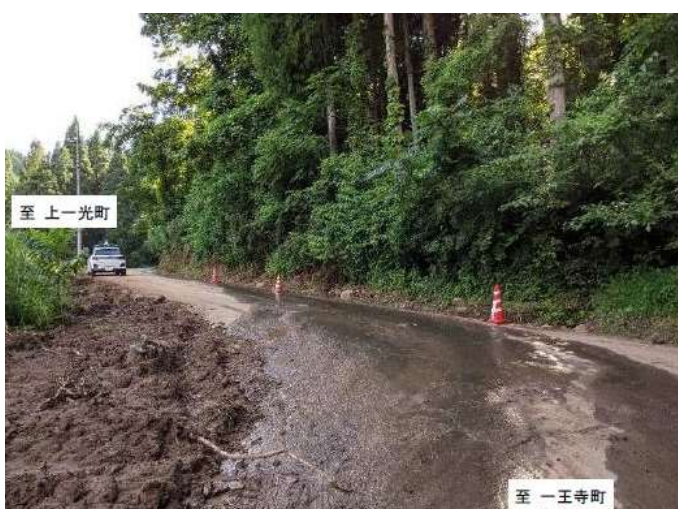
被災 No.62 土砂流出
