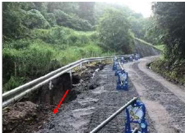
写真-8 溢水による洗堀（谷側）
