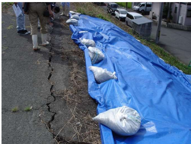
写真-3 崩壊部上部の新しい亀裂
