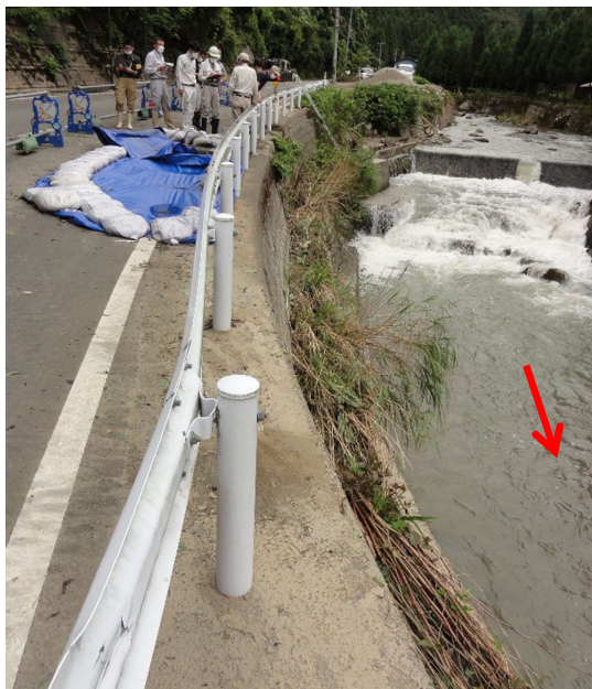
写真-5 陥没箇所（下流側から）
