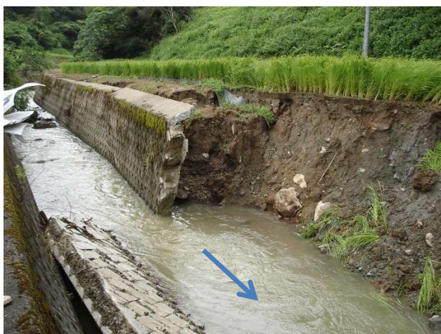
写真-9 崩壊箇所上流の護岸
