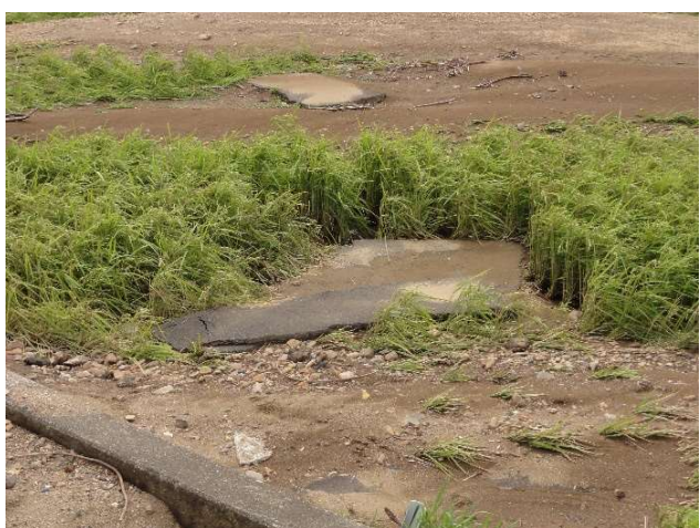
写真-10 流されたアスファルト舗装
