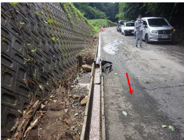
写真-3 谷側側溝の溢れと被災
