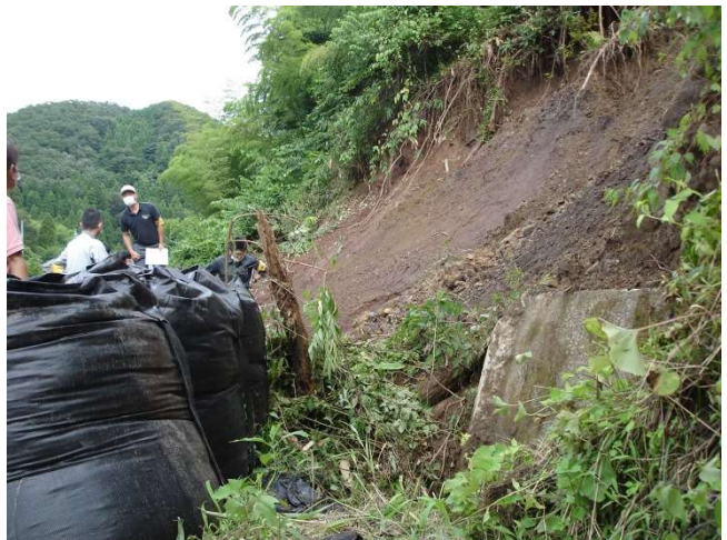
写真-13 右側部で残った擁壁
