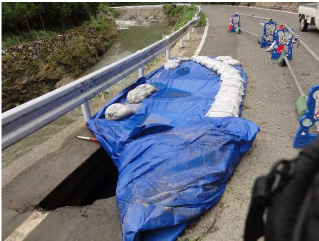
写真-9 陥没箇所（上流側から）
