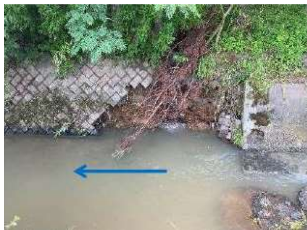
写真-7 上流部の護岸崩壊
