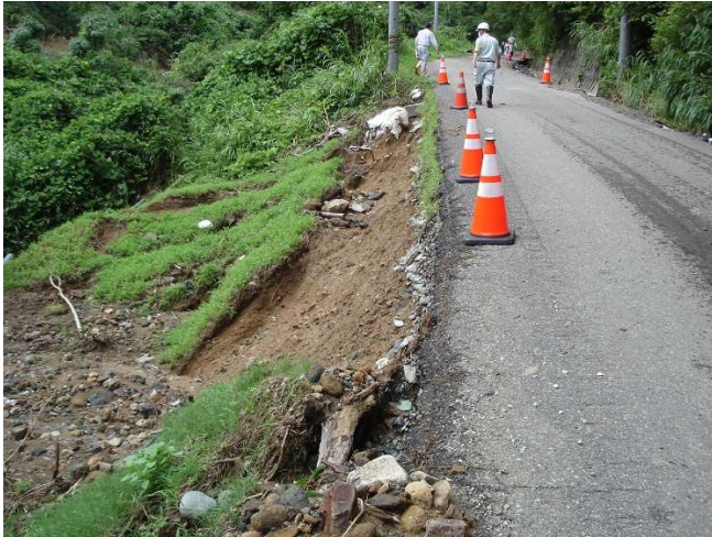
写真-11 下流部での路肩崩壊（谷側）
