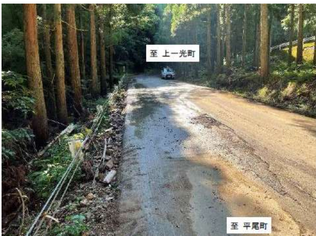
被災 No.61 路肩崩壊
