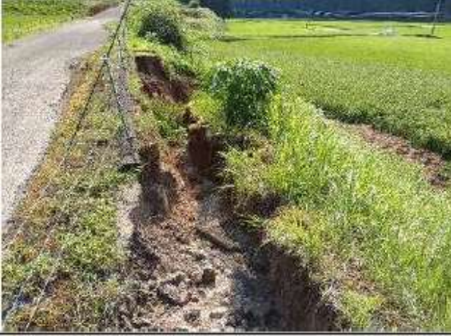
被災 No. 市 9 路肩崩壊
