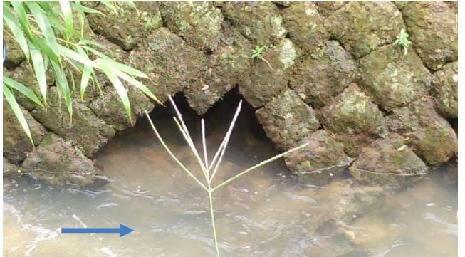
写真-6 左岸側被災箇所
