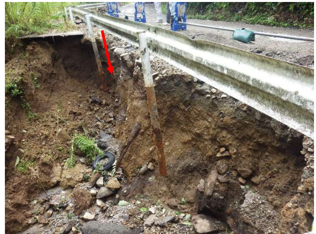
写真-12 路肩崩壊（谷側）
