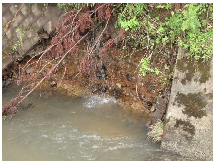
写真-8 上流部の護岸崩壊（基礎部）
