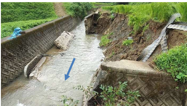
写真-3 護岸崩壊個所全景
