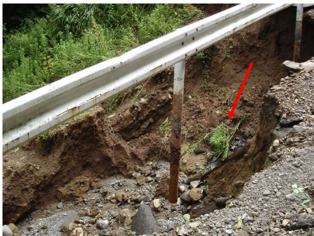
写真-9 路肩崩壊（谷側）
