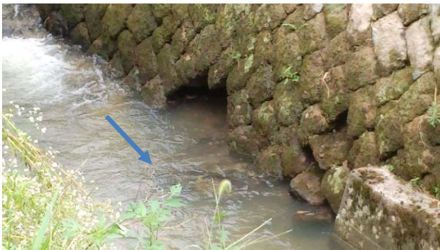
写真-5 左岸側被災箇所
