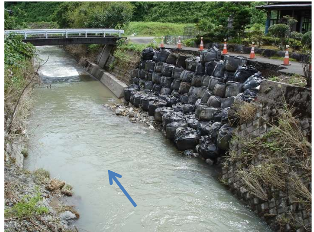
写真-4 被災箇所
