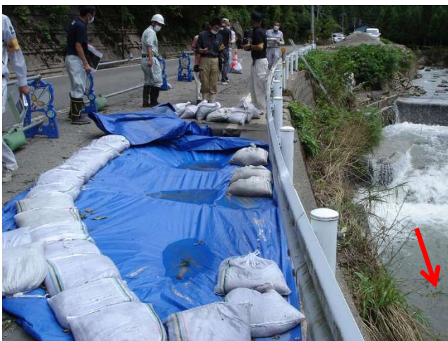
写真-11 陥没箇所（下流側から）
