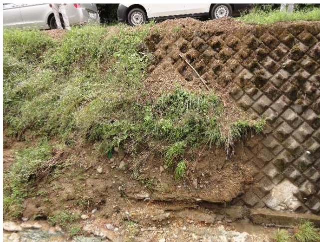
写真-8 破損した右岸側の護岸ブロック
