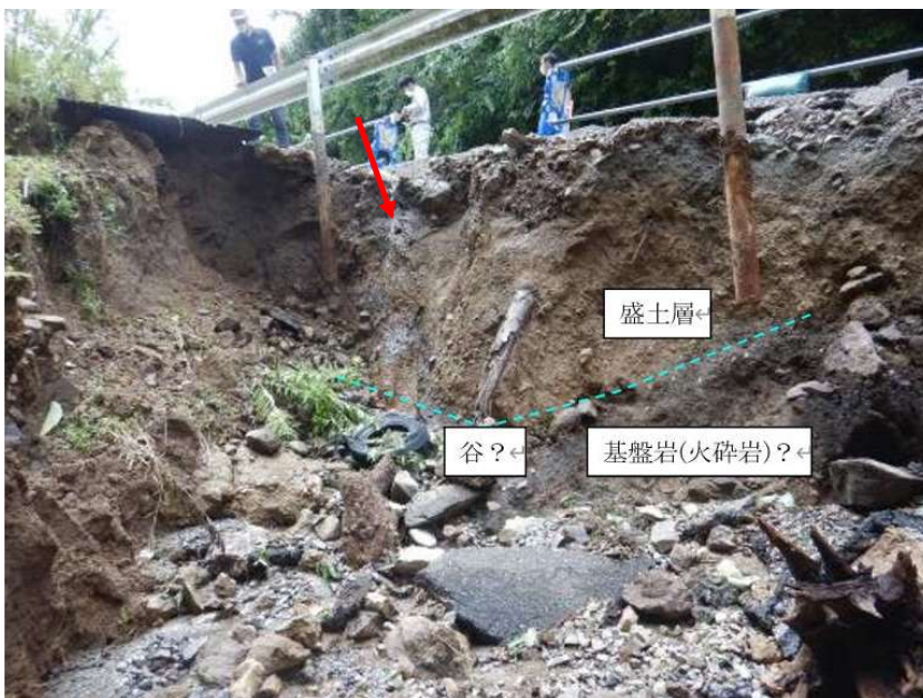
写真-13 路肩崩壊（谷側，下から撮影）
