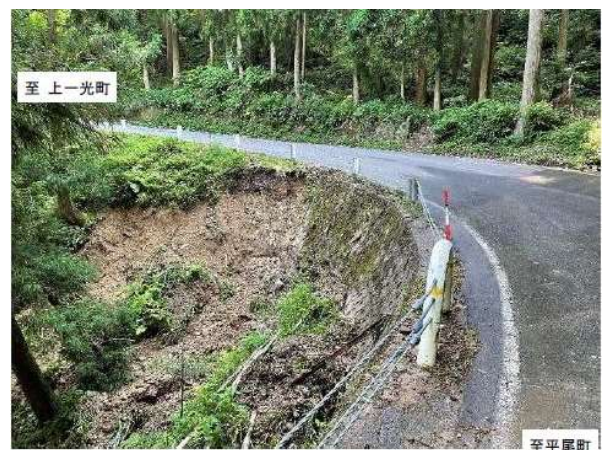
被災 No.60 路肩崩壊
