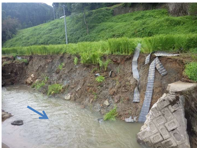
写真-5 護岸崩壊跡
