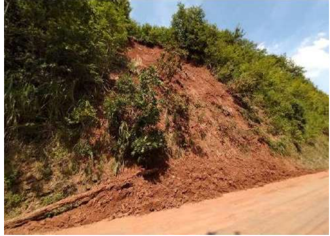
被災 No. 市 10 法面崩壊
