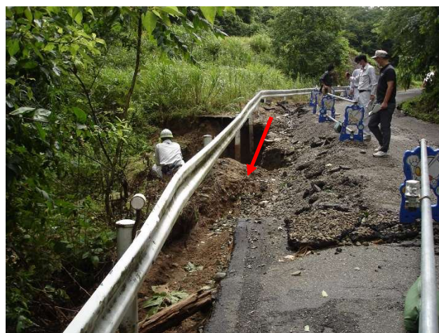
写真-10 路肩崩壊（谷側）
