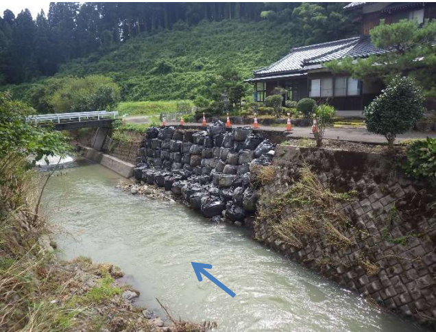
写真-3 被災箇所
