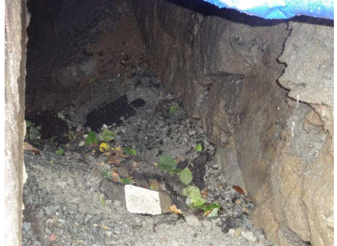
写真-10 陥没箇所内部
