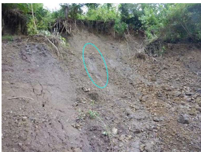
写真-6 崩壊面中央部の湧水
