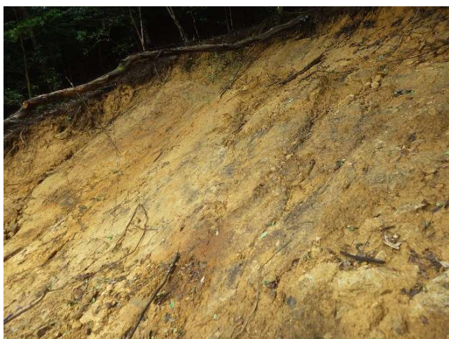
写真-7 崩壊面の露岩
