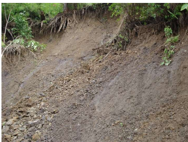
写真-8 湧水状況
