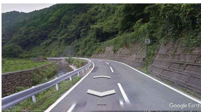
写真-1 陥没前のストリートビュー（上流側から）
