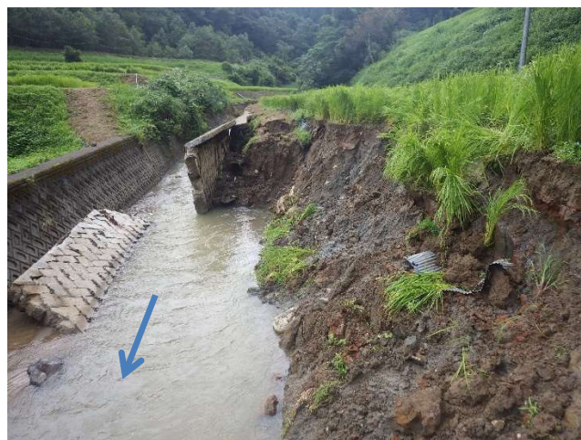
写真-6 護岸崩壊跡
