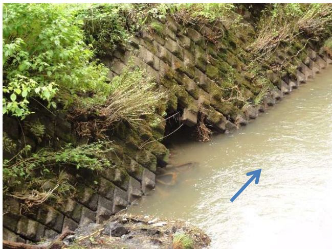
写真-1 下流部左岸側の護岸破損
