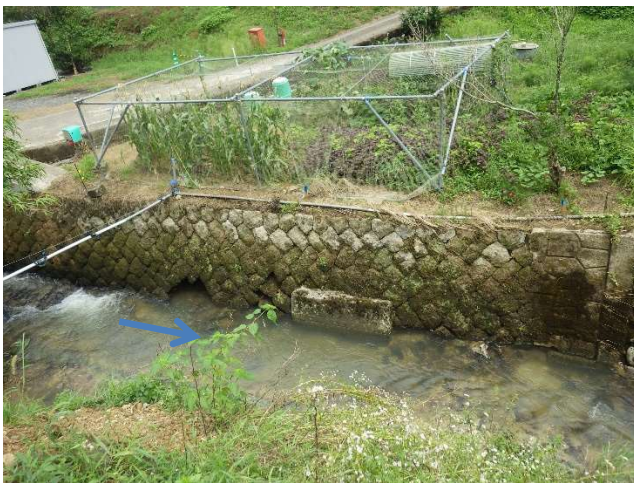
写真-3 左岸側被災箇所
