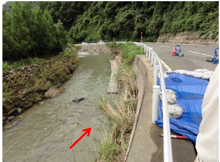
写真-6 陥没箇所（上流側から）
