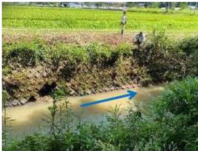
写真-2 下流部左岸側の護岸破損
