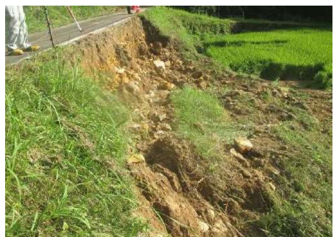
被災 No. 市 8 路肩崩壊
