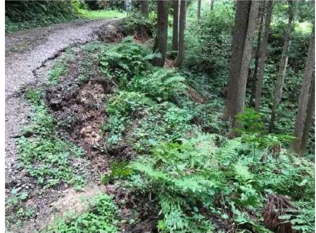
被災 No. 市 11 路肩崩壊
