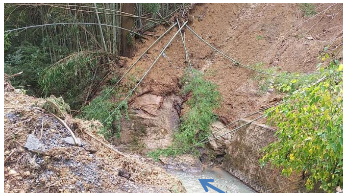
写真-10 崩壊斜面（左岸）下部の露岩
