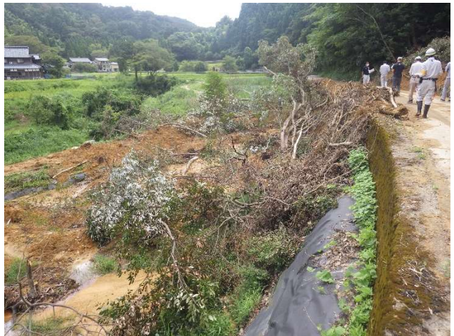
写真-4 崩壊土砂の流動
