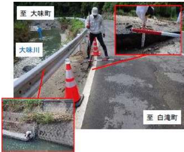
写真-3 被災直後（上流側から）
