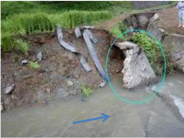
写真-11 この部分で水圧を受け止めた
