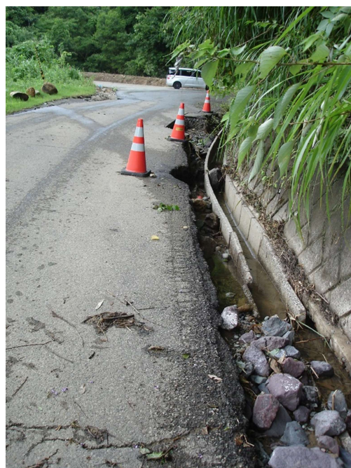
写真-10 下流部からみた側溝破損（山側）
