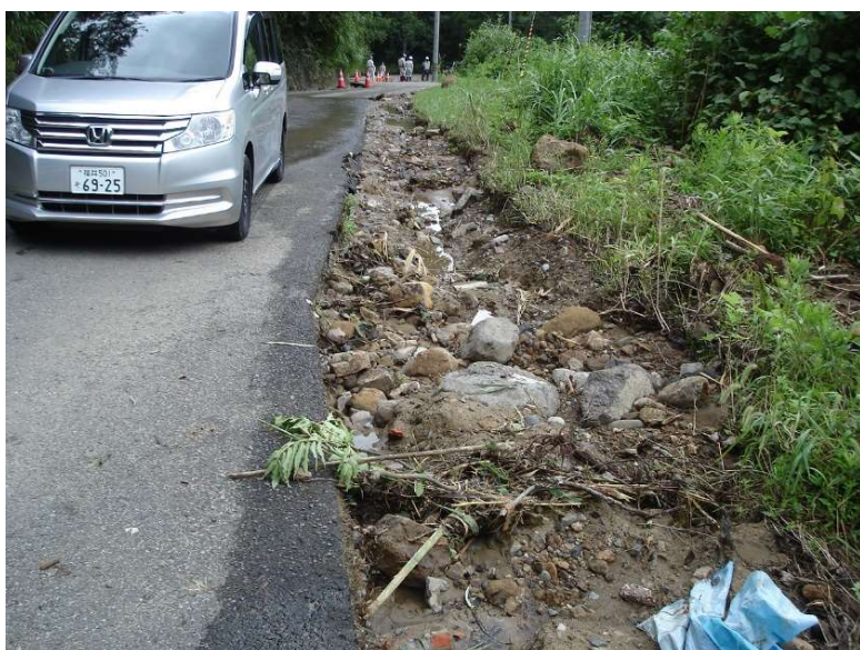
写真-9 上流部からみた路肩洗堀（谷側）
