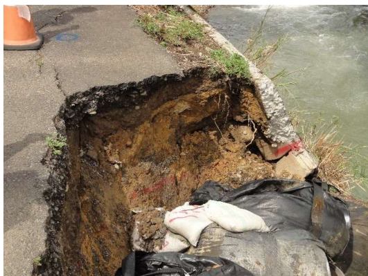
写真-7 護岸背面の崩壊部
