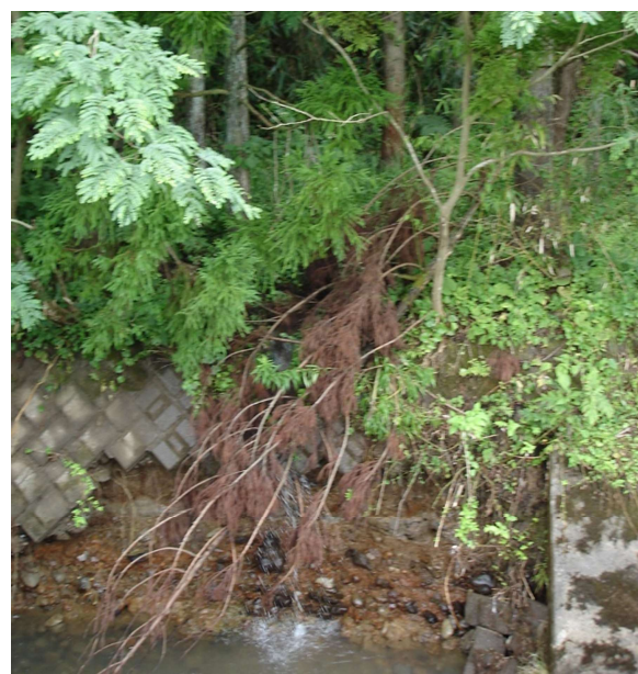
写真-9 上流部の護岸崩壊（背後の流水）
