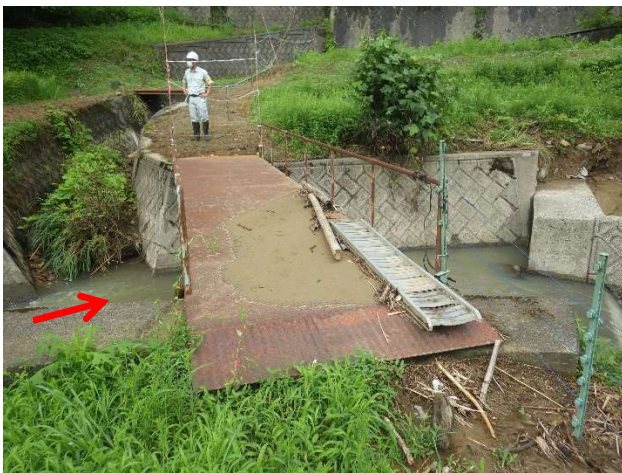
写真-13 渡り橋上の土砂痕跡
