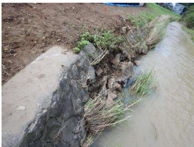
写真-13 決壊箇所上流部の護岸崩壊状況
