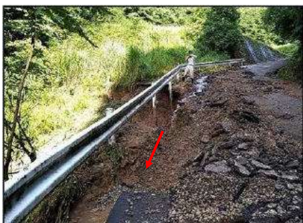
写真-7 溢水による洗堀（谷側）
