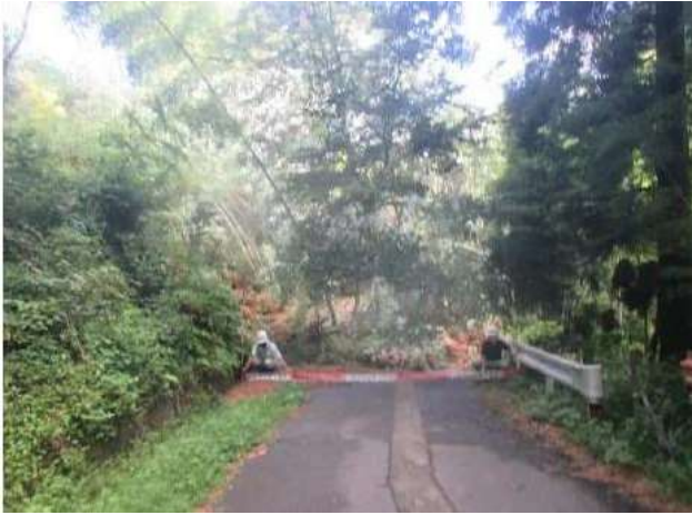
被災 No. 市 7 法面崩壊
