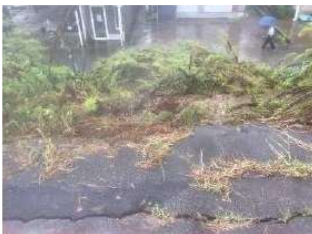
写真-5 崩壊直後（上部から）
