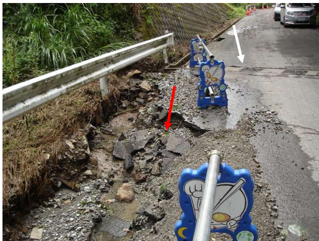
写真-5 横断水路（白矢印）と溢水による洗堀（谷側）
