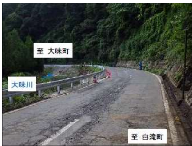
写真-2 被災直後（上流側から）
