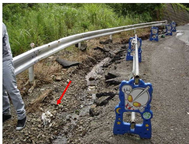
写真-6 溢水による洗堀（谷側）
