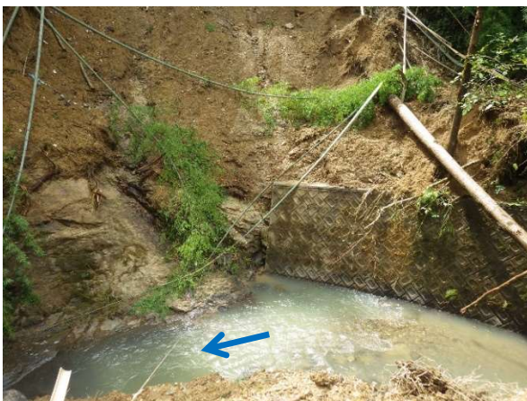
写真-9 崩壊斜面（左岸）下部の露岩
