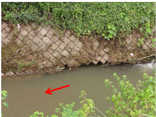
写真-3 下流部右岸側の護岸破損
