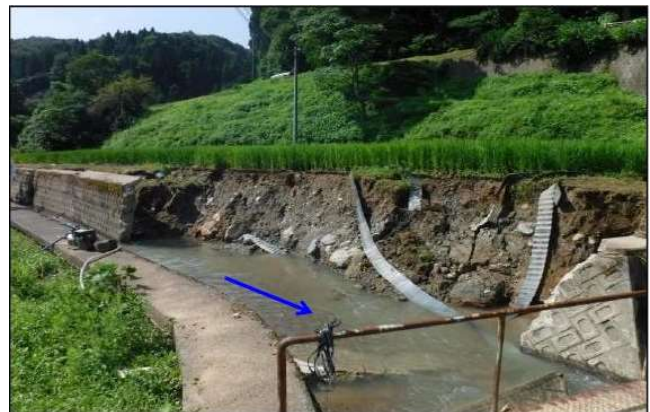
写真-4 護岸崩壊個所全景
