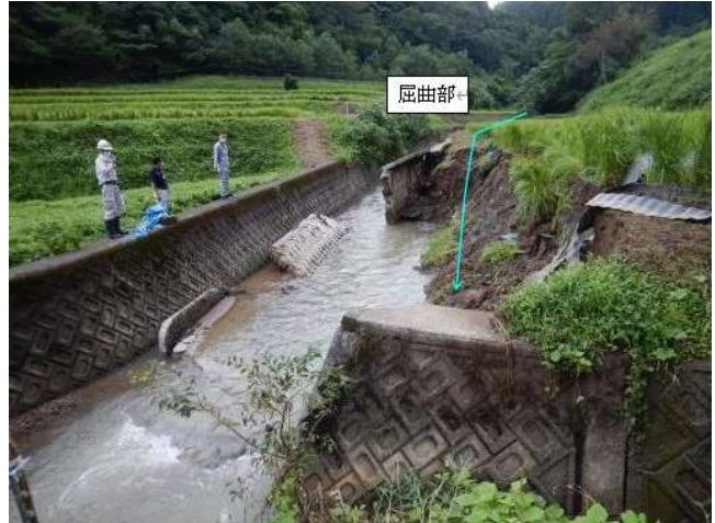
写真-12 上流部での越流水が被災個所に到達
