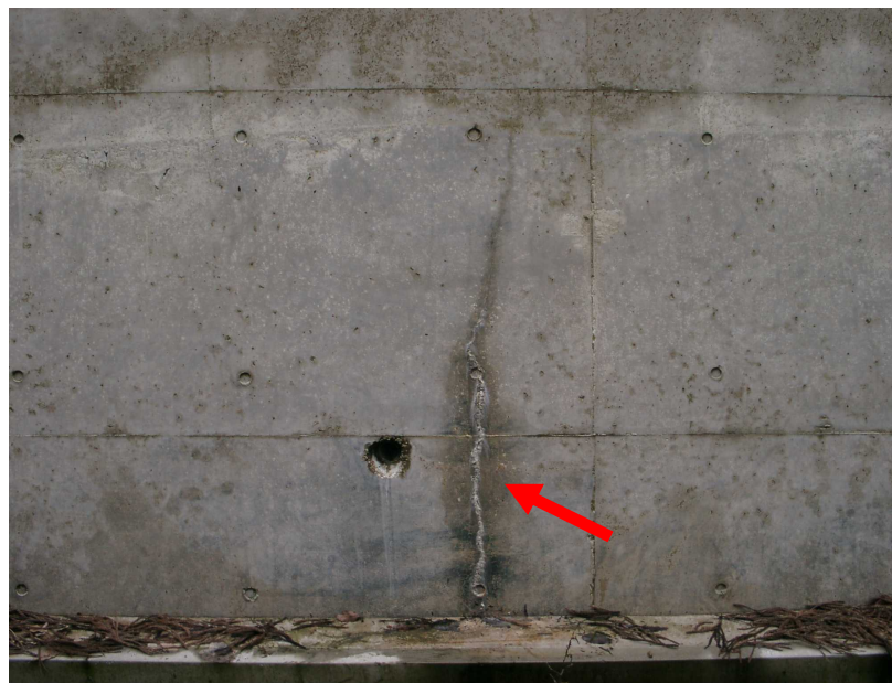
写真 12-3 高炉セメントコンクリート打設箇所に発生した乾燥収縮ひび割れ
