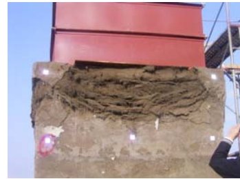
No.2 壁面無し 繊維有り
