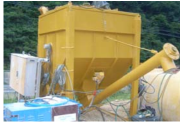
固化材サイロ供給機
