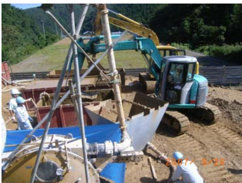
プラント機材配置状況
