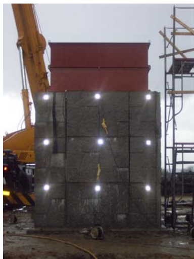
壁面変位ターゲット(壁面材有り)
