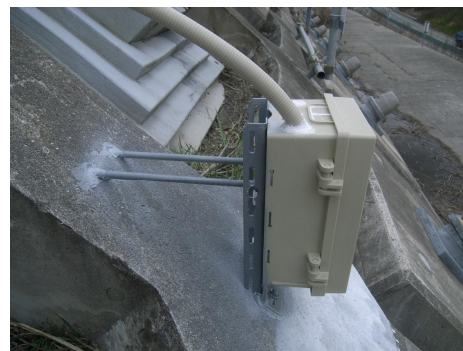
図 8.4.5 警報表示器設置状況
