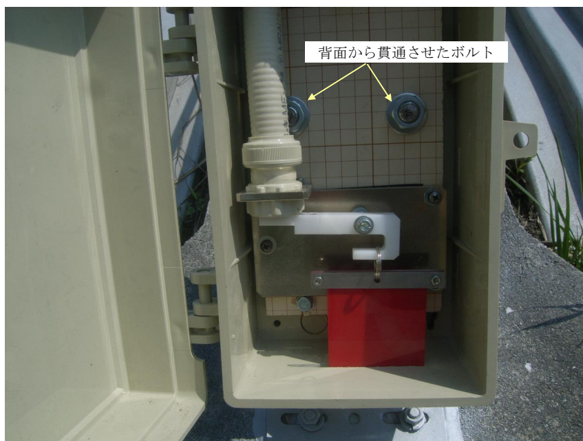
内部の状況 ボルトが内部まで貫通して取り付けられていることが分かる
