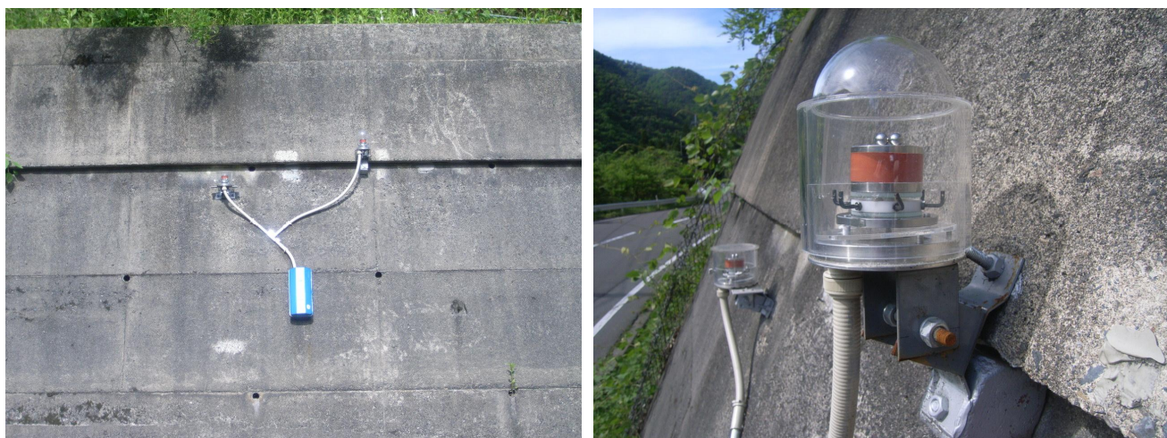
図 8.2.2 検知器本体および警報表示器の設置状況
