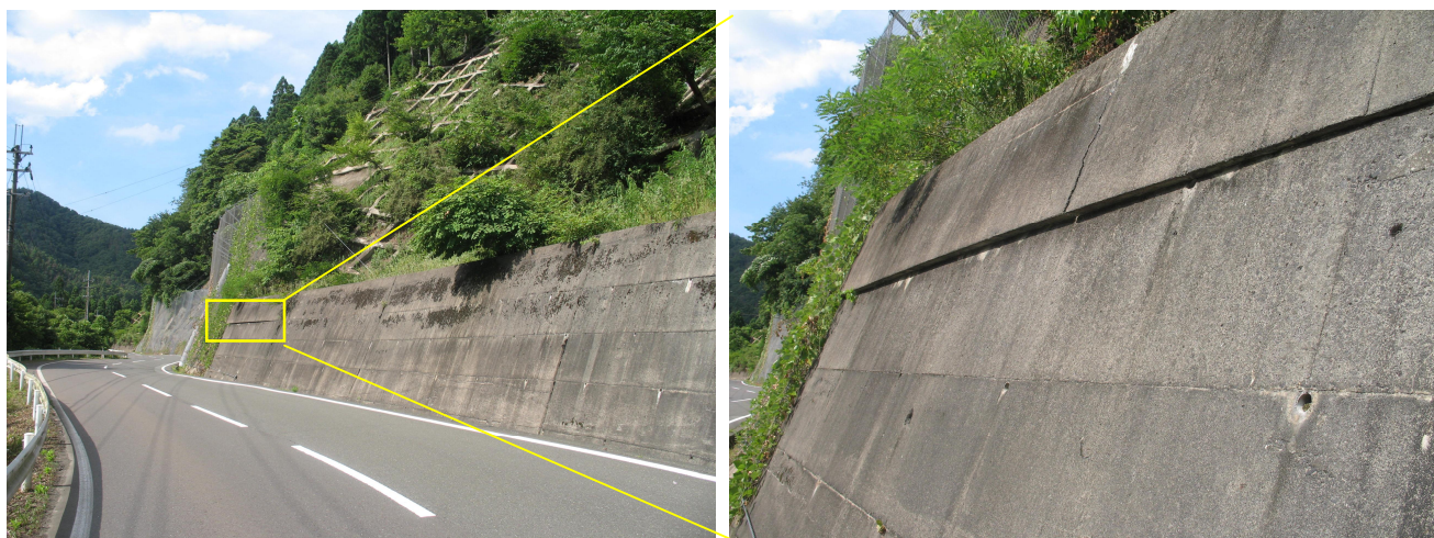
図 8.2.1 擁壁の変状状況
