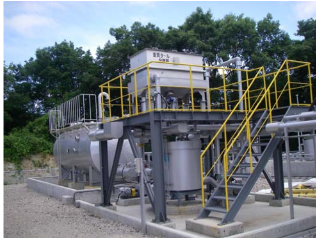
写真 2.1 発電施設内の木タールタンク
