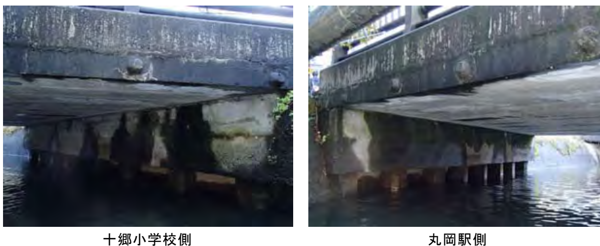
写真-8.3.2 十郷橋の橋台の漏水状況
