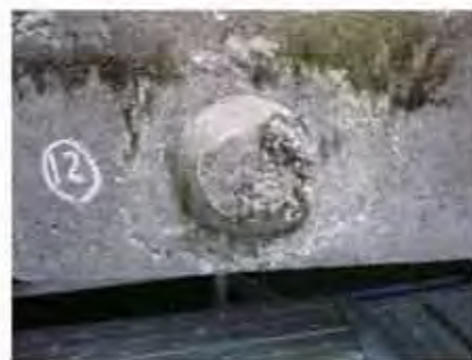
⑫横締め PC 鋼材露出 保護モルタルの割れ
