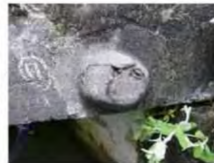
⑪横締め PC 鋼材露出 保護モルタルの割れ
