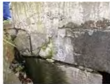
⑧左岸端部の浮き・割れ
