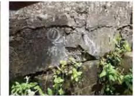
⑦右岸端部の浮き・割れ
