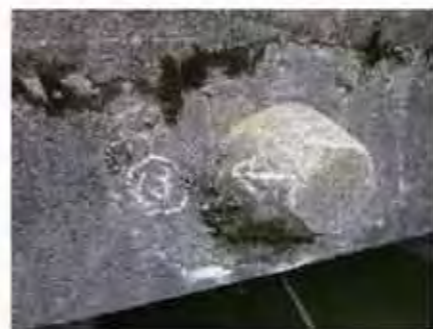
⑬横締め定着具の一部露出
