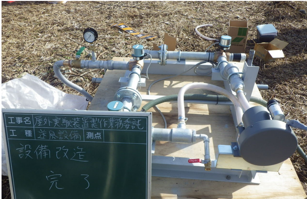
図 64 送風設備配管外観（VB-001S-E）
