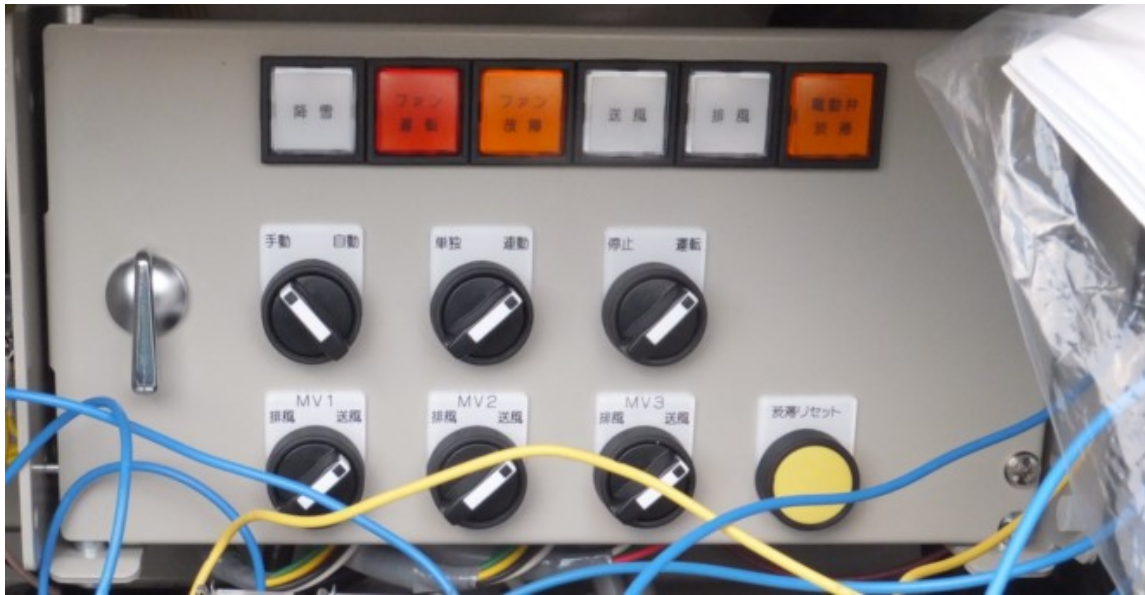
図 62 送風機の配電盤内部
