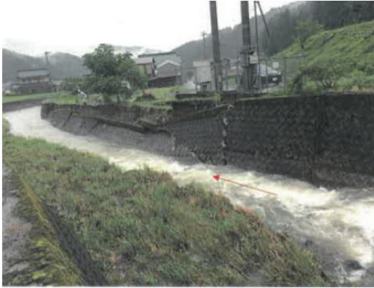
(a) 崩壊の状況（災害直後）
