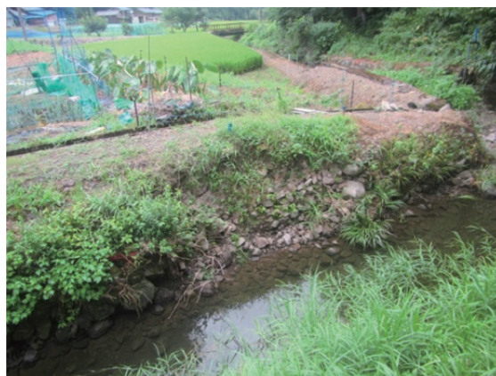
(b) 護岸の崩壊
