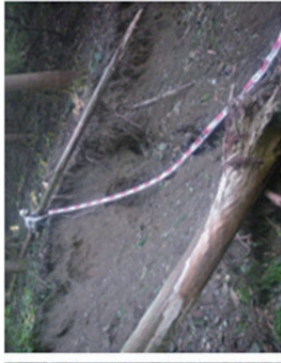
P-8 左岸側の崩壊頭部付近の拡大 斜面長約4.0m、斜面勾配70% 礫混じり砂質土を主体とする 土石流堆積物
