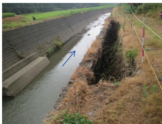
(b) 裏込め土の流出
