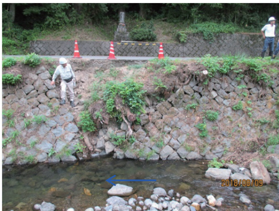
(a) 護岸の崩壊
