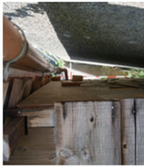
P-14 Cブロックの擁壁がBブロック側に傾斜している(貸与資料では約9°)。
