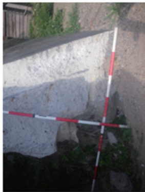
P-11 Bブロックの破断箇所(測点 No.4)の擁壁下部に「段切り」箇所があり、背面は玉石混じりの砂礫が分佈。
