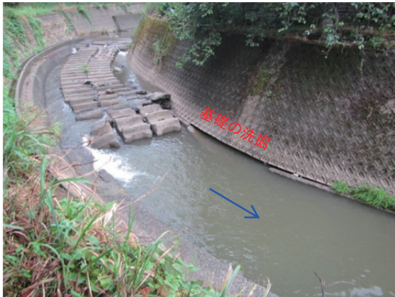
(a) 基礎前面の洗掘
