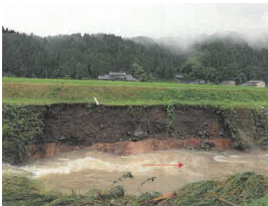
(a) 護岸の崩壊 (災害直後)
