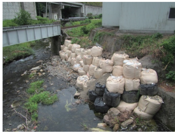
(b) 崩壊の状況
