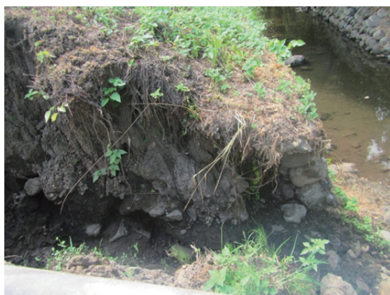
(a) 護岸の崩壊
