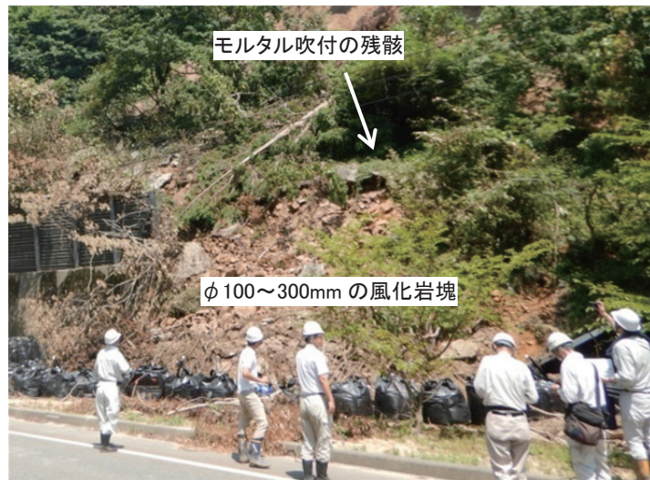
図-3.3.4 モルタル吹付部の崩積土
