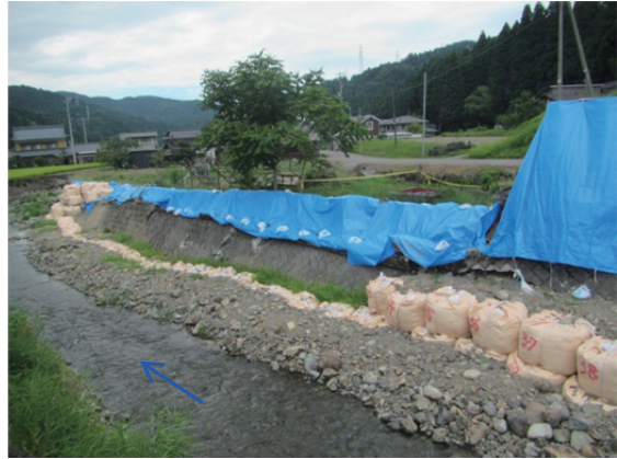
(b) 崩壊の状況
