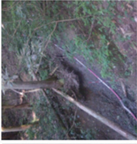
P-9 左岸側の崩壊頭部の状況 斜面不安定で二次崩壊の危険 あり。上方斜面が不安定化して いる。
