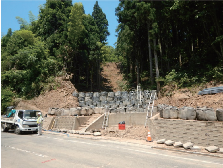
図-3.4.3 崩壊箇所の全景
