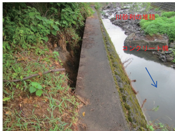
(b) 裏込め土の流出
