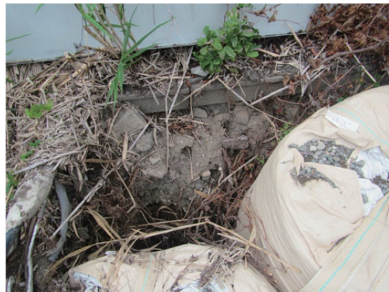
(d) 裏込め土の流出の跡
