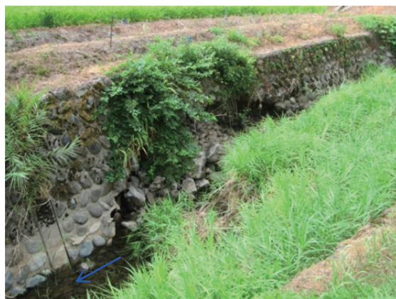
(b) 護岸の崩壊
