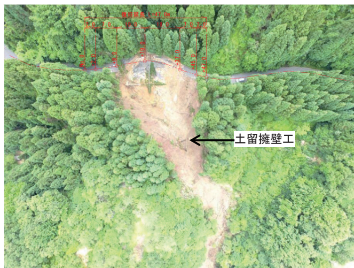
図-3.7.2 崩壊箇所の空撮写真
