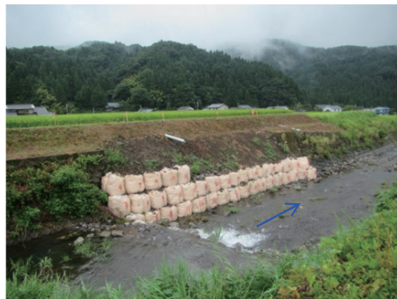
(b) 護岸の崩壊
