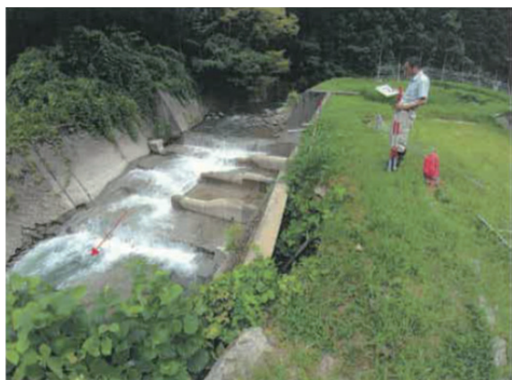
(a) 基礎前面の洗掘
