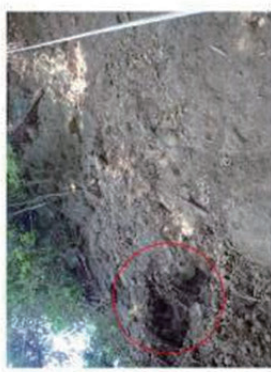
P-13 標高 90~98m付近の崩壊頭部付近の地 盤状況 礫岩の多い強風化岩が分布する。崩壊頭には 木根が露っており、極表層部分が崩壊を生じて いる。(丹南土木の貸与資料から抜粋)
