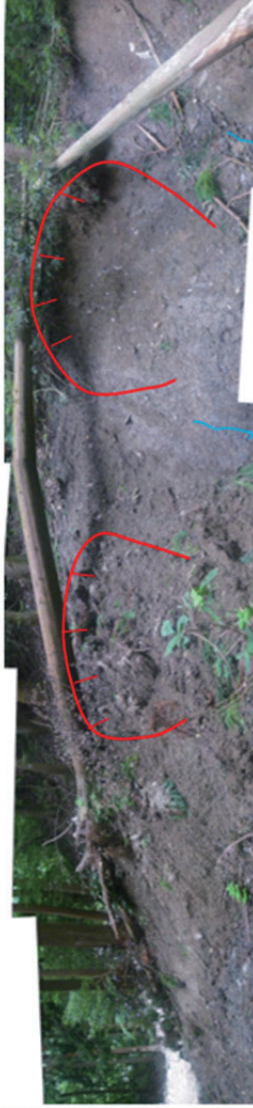
P-5 崩壊地右岸側面の状況 斜面頭部付近の斜面は比較的平滑である。幅3~4m程度の小規模な崩壊跡が2箇所発生している。表面水の浸透が地下水がすべり面の下端付近から染み出ている。一方、の斜面中腹には崩壊土が厚く堆積している。
