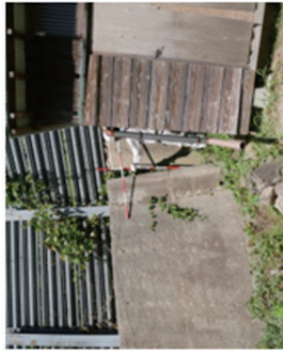
P-13 BとCブロックの境界付近(測点 No.5+2.5)で約20cmの隙間が生じている。
