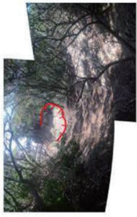
P-14 崩壊頭部の上方斜面状況 標高 90~110m付近で、雑木が生えている。 で崩壊斜面に向かって、表層の土砂や表層水が流下する。 すり鉢状
