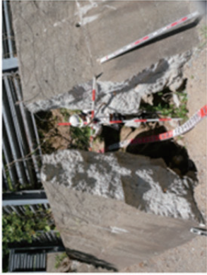
P-2 Bブロック測点 No.4 付近の擁壁破損状況
