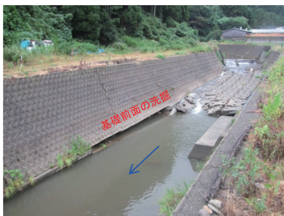
(a) 基礎前面の洗掘
