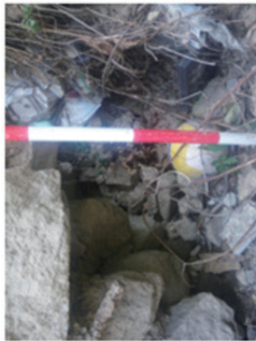
P-12 Bブロックの破断箇所(測点 No.4)の擁壁下部に「段切り」箇所があり、背面は玉石混じりの砂礫が分佈。
