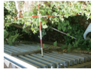
P-7 Aブロックの測点 No.2 付近の擁壁背面と地山の間に約 70 cmの隙間を生じた。
