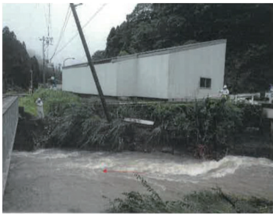
(a) 崩壊の状況（災害直後）
