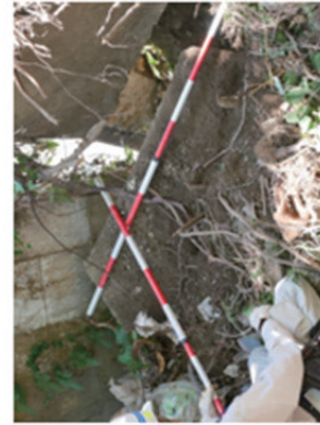
P-9 左の写真を擁壁背後(測点 No.2とNo.3 間)から撮影。コンクリートブロックが落下転倒している。
