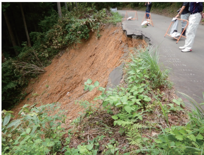
図-3.6.6 崩壊箇所の全景
