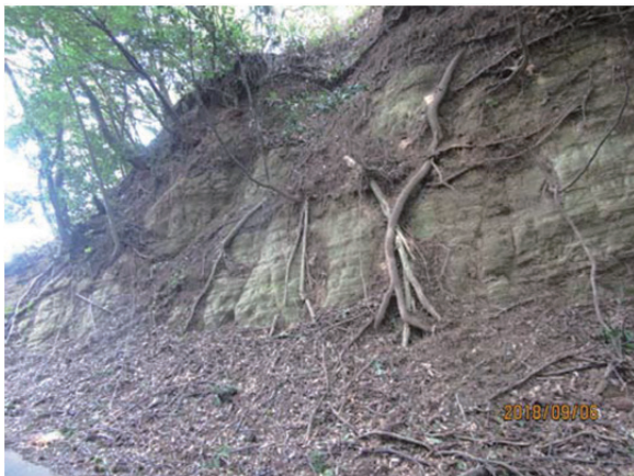
P5 崩壊斜面上部の平坦面地形
