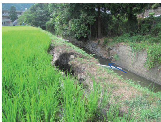
(a) 護岸の崩壊
