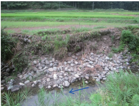
(a) 護岸の崩壊
