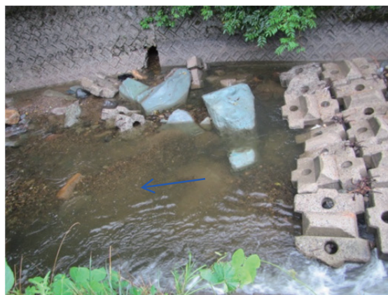
(b) 根固めブロックのめくれ
