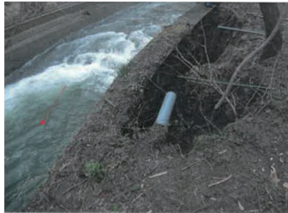
(b) 裏込め土の流出
