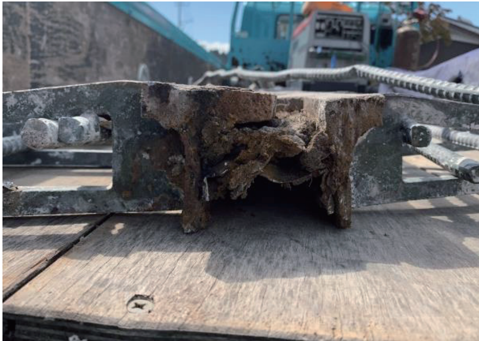
図 28 劣化した伸縮装置
