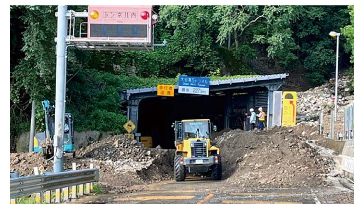
土砂で埋もれた国道8号トンネル 令和4年8月5日 敦賀市余座 福井県安全環境部危機対策・防災課 提供
